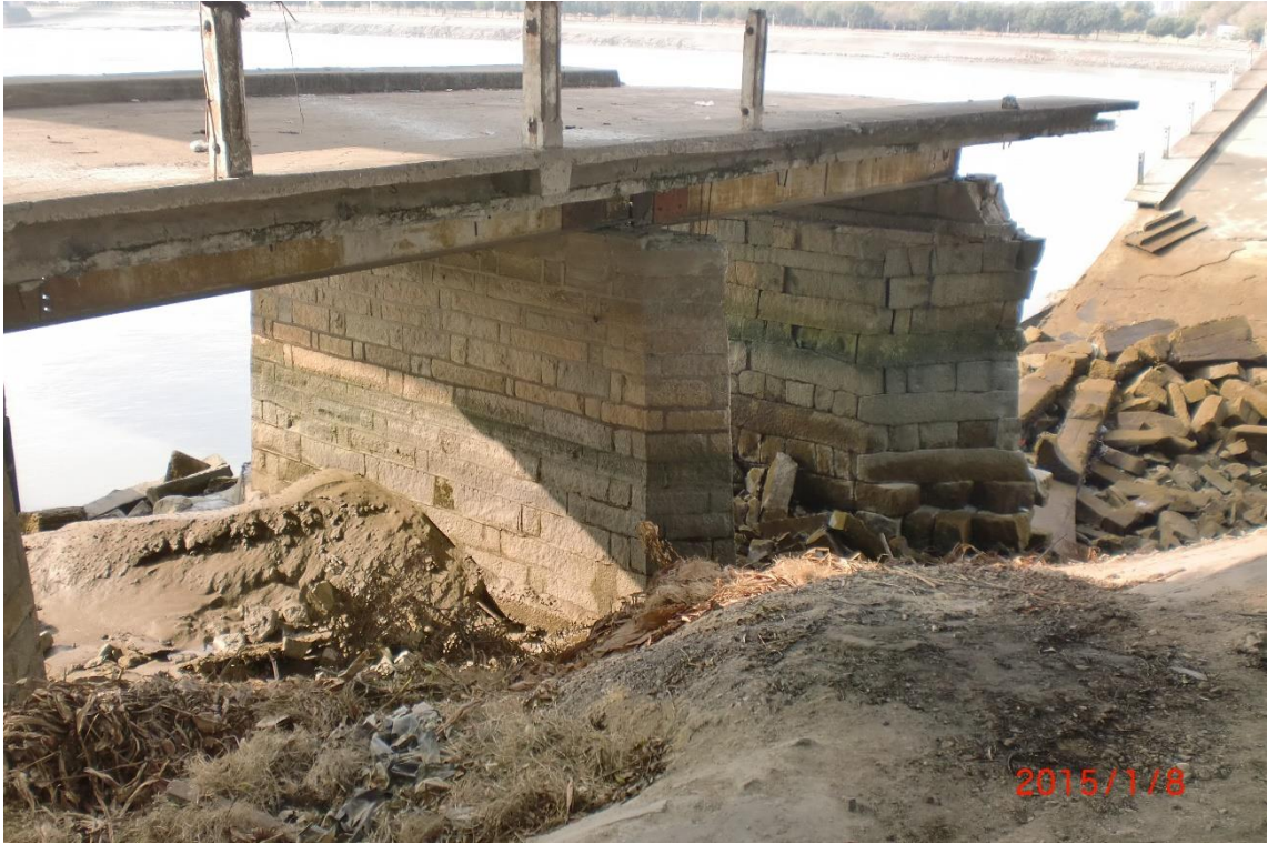
图1 崩落した順濟橋（東端）
