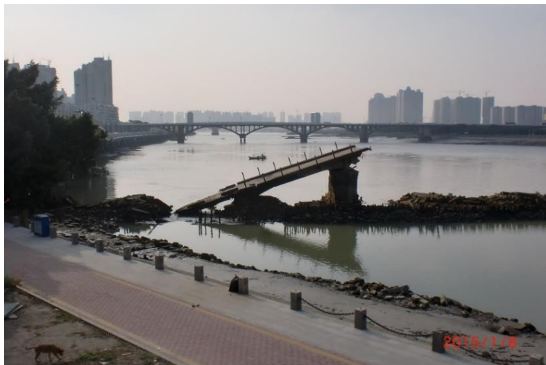
図 4 順濟橋、崩落した東端の一部
