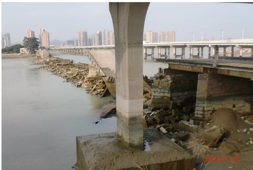
図7 同 崩落が進行している（2015年1月）
