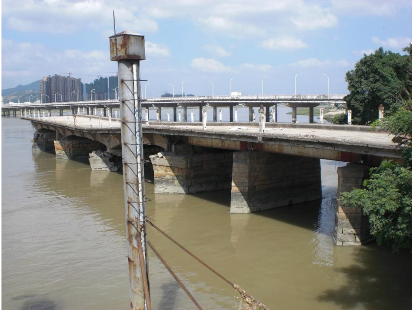
図6 順済橋東端下流側 橋脚の先端が尖がっている（2009年9月）
